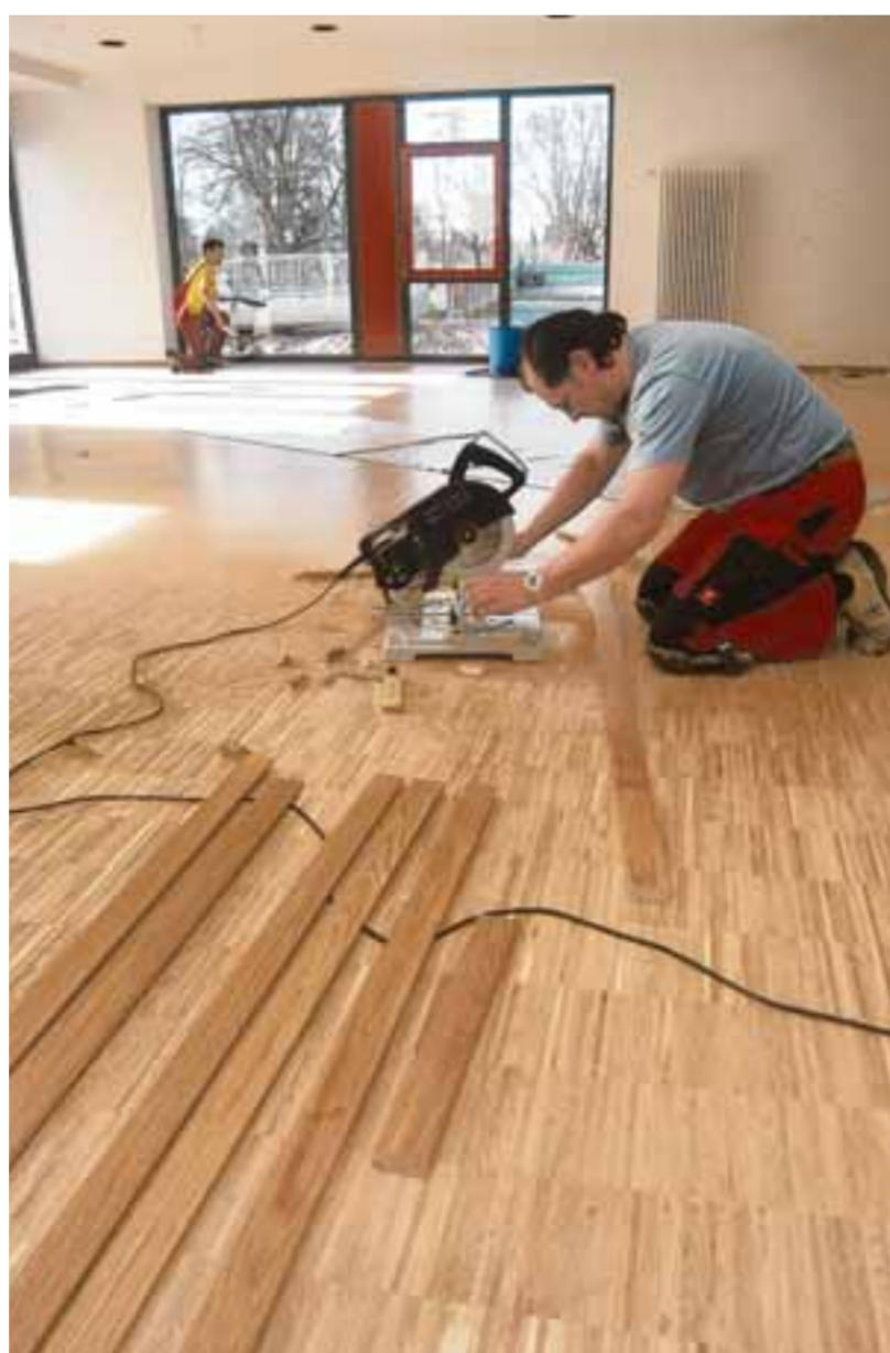
Das Domizil, das der städtischen Wohnungsbaugesellschaft gehört, konnte mit Industrie-Parkett ausgestattet werden.
